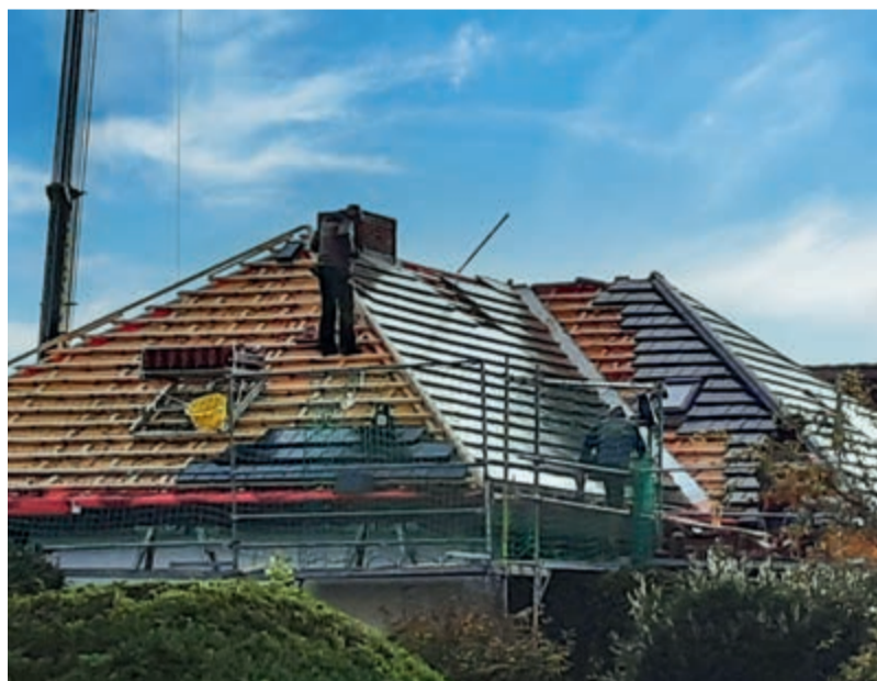
Winkel und kleine Dachflächen – keine leichte Situation um ein Dach mit Solardachziegeln zu decken. Die Dachfläche wurde in insgesamt 16 Felder für die Verkabelung unterteilt.
